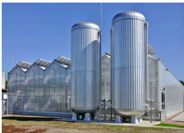
Abb. 3.1 ZINEG-Haus-Hannover mit Kurzzeitwärmespeicher für das Solarspeichersystem (Quelle: Horscht)
