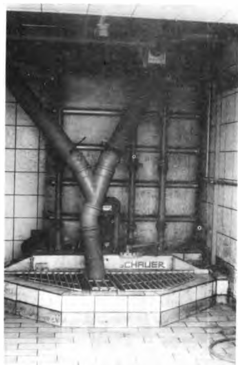
Abb. 5: Futteraufberei- tungs- raum mit versenktem Mischbottich
