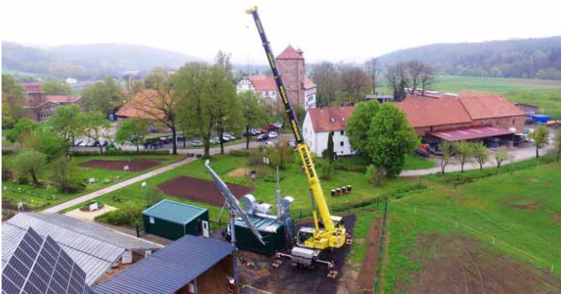
Abb. 2: Aufstellung eines inselnetzfähigen Biogas-BHKW am Hessischen Biogas Forschungszentrum (HBFZ) in Bad Hersfeld (© Fraunhofer IEE)
