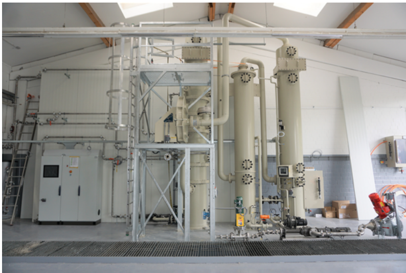
Abb. 1: Ammoniakstrippungsanlage der FH Münster (© FH Münster)
