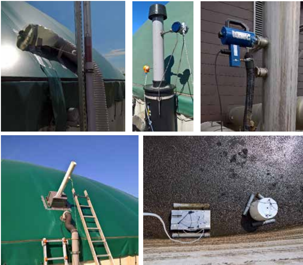
Abb. 1: Einzelmethoden des On-site-Methoden im Praxiseinsatz; links oben: Einhausung und Messung an einer Leckage mittels belüfteten Folientunnel; mittig oben: Dauermessung des Auslösen von Über-/Unterdrucksicherungen; rechts oben: beheizte Gasprobenahme an einer geführten Quelle (BHKW-Abgas); links unten: Messung der Stützluftemission in Doppelmembranspeichern; rechts unten: Haubenmessungen an einem offenen Gärrestlager mit offenen und geschlossenen Hauben (© Torsten Reinelt, DBFZ)
