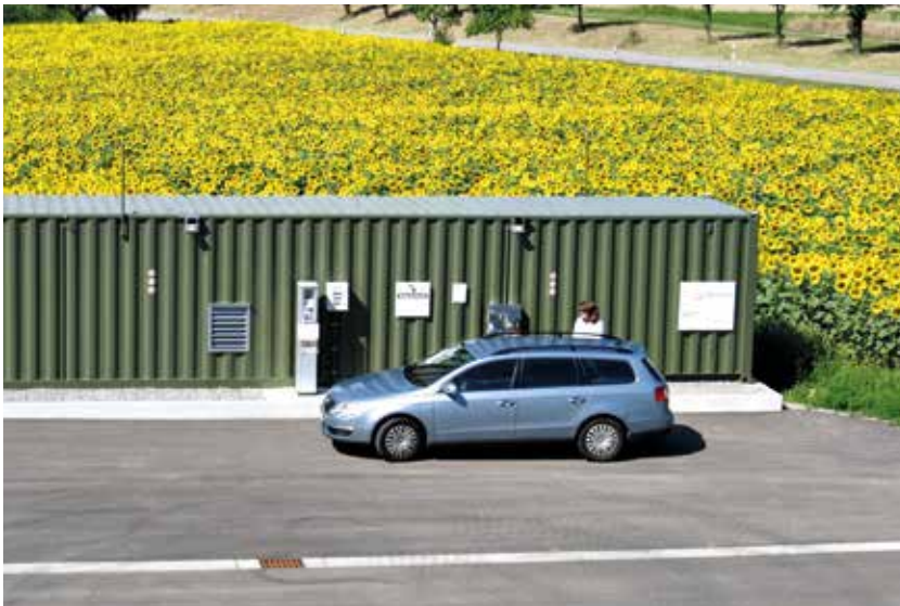
Abb. 4: Container mit Aufbereitungsanlage sowie Tankstelle inklusive EC-Kartenautomat (© Winfried Vees)
