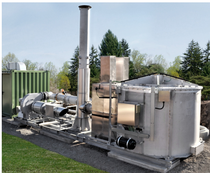
Abb. 9: Regenerative thermische Oxidationsanlage (RTO) zur Schwachgasbehandlung ab einem Methangehalt von 0,7 Vol-% (© BMF HAASE GmbH)
