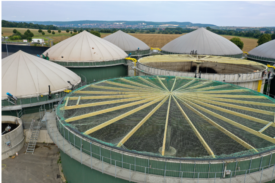
Abb. 5: Fermenter einer Biogasanlage mit Doppelmembranhauben, teils mit geöffnetem Dach (© Landpixel)
