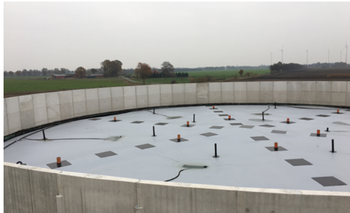
Abb. 7: Gasdichte Schwimmfolie mit Gasfassung in einem Gärrestlagerbehälter. Die Folie liegt auf der Gärrestoberfläche auf. (© N-E-ST, Neue Energie Steinfurt GmbH)
