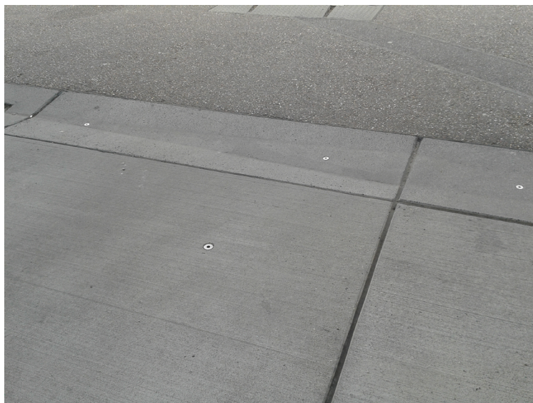
Abb. 4: Waschplatz mit Absenkrinne (© M. Krause)
