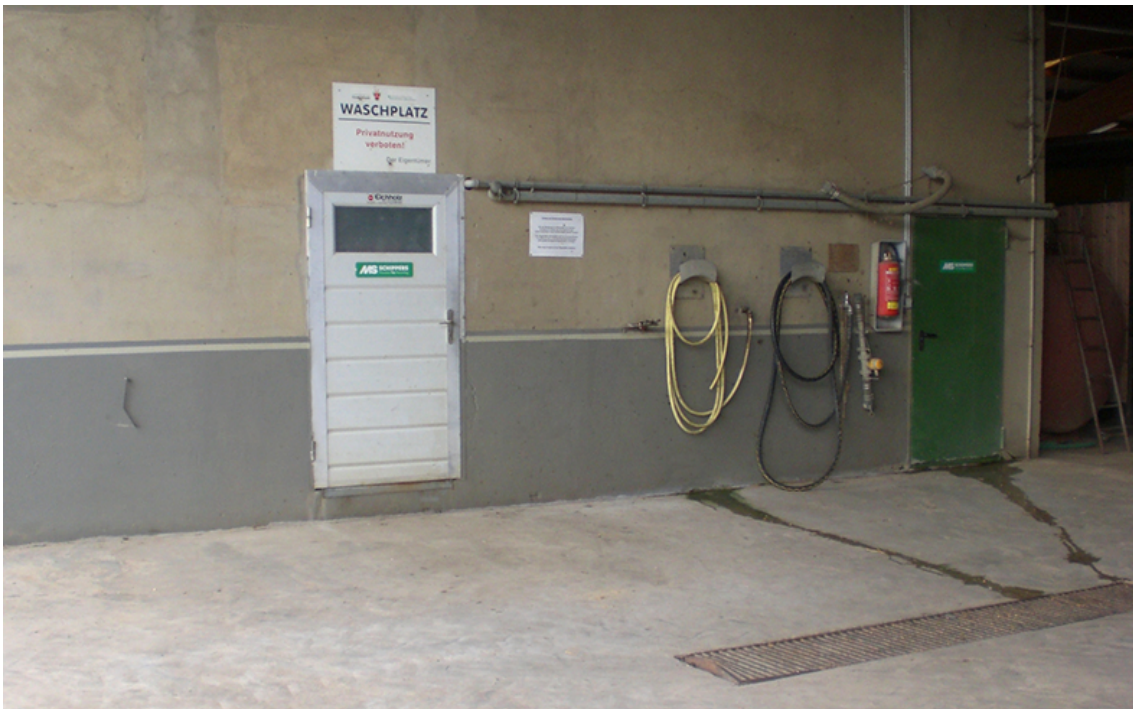
Abb. 1: Ein Grobschlammfang gehört zu jedem Waschplatz. (© M. Vaupel)
