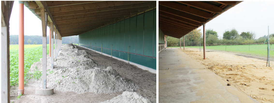
Abb. 13: Übergangsbereich mit Dachüberstand, Untergrundmaterial ist hier Sand oder Betonsockel. Ein Bodenaustausch ist aus hygienischen Gründen wichtig (© Julia Lüssing-Griese)
